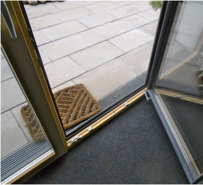
1 Vorhandene Türschwellen müssen nach der DIN 18 040 zum Boden kontrastierend gekennzeichnet werden.
