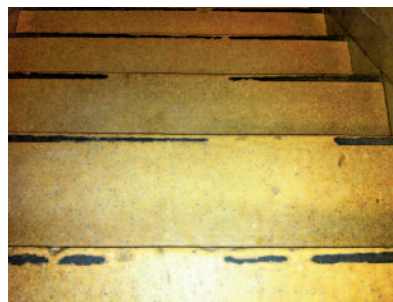
6 Die Markierungen sind hier stark beschädigt und teilweise überhaupt nicht mehr wahrnehmbar. (Foto: Dietmar Böhringer)
